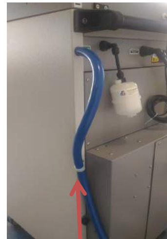
BLAUER SCHLAUCH FÜR DEN WASSEREINLASS, MIT KABELBINDER AM HAUPTTRAHMEN BEFESTIGT
